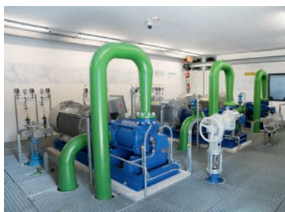
Strom aus Eigenproduktion Self-generated electricity
